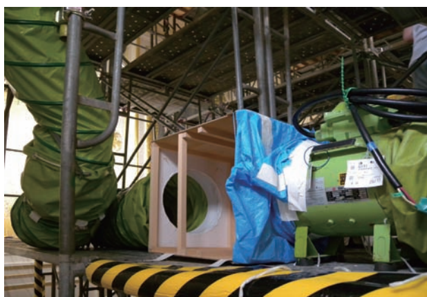
図15 溶剤型吸着用活性炭入りフィルター装置と 防爆型送風機を設置した状態
