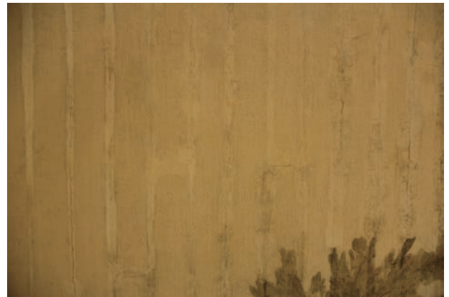
図3 帯状に白く見えているのが旧充填剤が溶け出した部分
